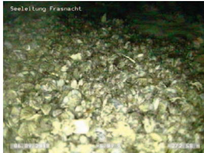
Abb. 8: Muschelbewuchs in der Entnahmeleitung der Regionalen Wasserversorgung St. Gallen (RWSG), Seewasserwerk Frasnacht (Sept. 2018)
